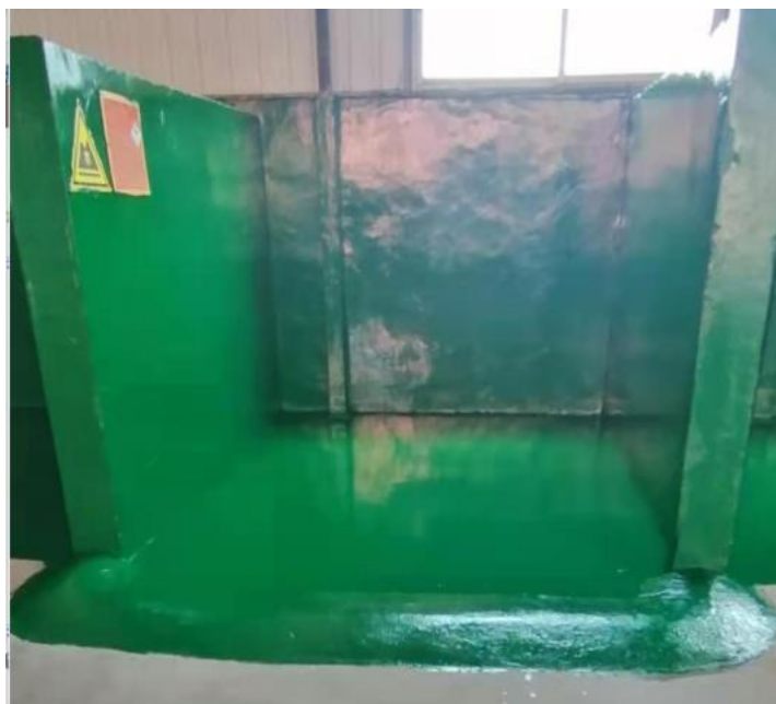
图 2.7-2 废树脂粉暂存间防渗及围堰
